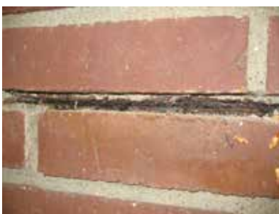
Bild 1.11. Fogen har tryckts ut och blottar armeringsjärnet.
