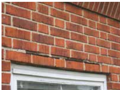
Bild 1.15. Fogen har tryckts ut och blottar armeringsjärnet.
