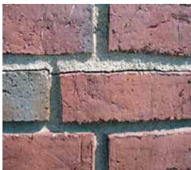
Bild 4.16. I skalmuren har yttre järnet tagits bort och ersatts av rostfri stång, medan det inre lämnats kvar. Nya sprickor har utvecklats, några år efter åtgärden.
