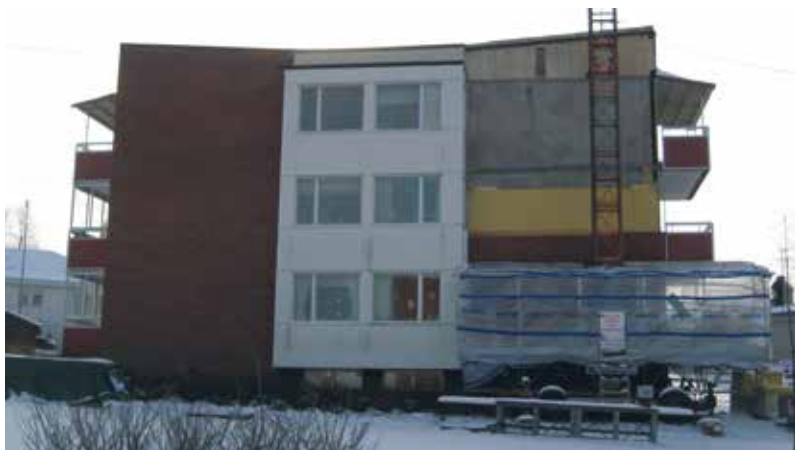
Bild 5.1. Skalmuren t.h. om burspråksdelen rasade vid stormen. Delen ovan betongstommen har täckts provisoriskt med skivor.
