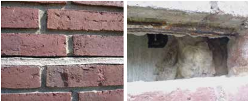
Bild 1.4 och 1.5. Kvarlämnad inre armeringsstång i skalmur orsakar nya sprickor inom ett fåtal år. Högevallsbadet, Lund, byggår 1979.
