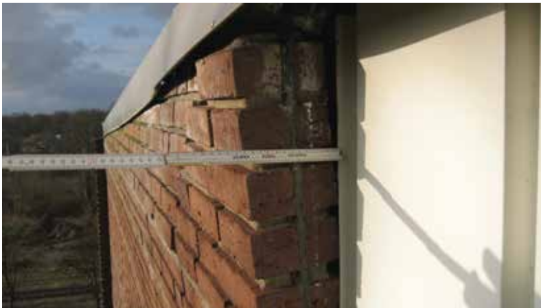
Bild 5.2. I anslutningen mot taket hade fasadmuren vikt sig utåt.
