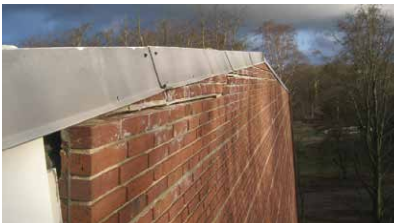
Bild 5.3. Murkrönet av den ca 14 m höga kanalmuren hade förlängts ca 60 mm. Den hölls tillbaka av en krönplåt.
