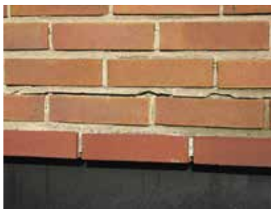
Bild 1.13. Spricka över muröppning.
