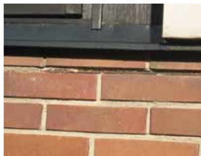
Bild 1.14. Fogen har tryckts ut och blottar armeringsjärnet under fönstret.
