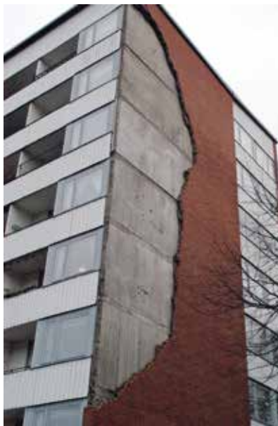
Bild 1.7. Klostergården i Lund, fasadras i samband med stormen Gudrun i januari 2005.
