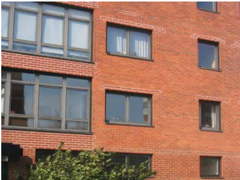
Bild 1.6. Fasad efter renovering p.g.a. armeringskorrosion vid bostadsområdet Klostergården, Lund.
