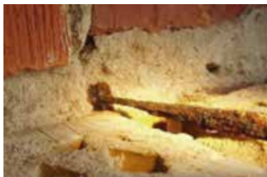
Bild 1.17. Rostangripen kramla i en kanalmur. Kramlan har påverkats mest i den del som inte varit inmurad, sannolikt p.g.a. högre fuktbelastning.
